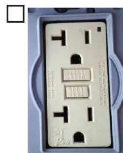
120 Volt, 20 Amps, GFI
